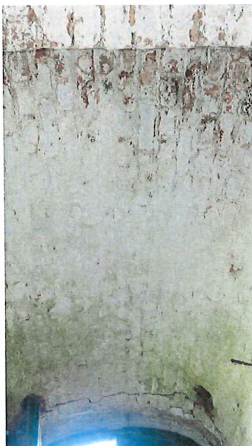
Photo 13 : escalier d'entrée Fissure entre le fronton d'entrée et le corps du bâtiment
