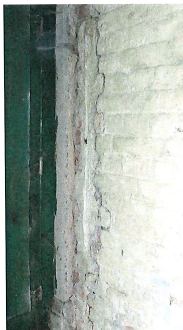
Photo 14 : escalier d'entrée Fissure entre le fronton d'entrée et le corps du bâtiment
